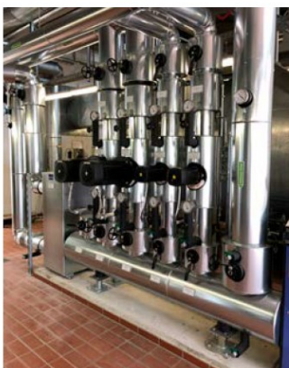
Verteiler für Kaltwasser
