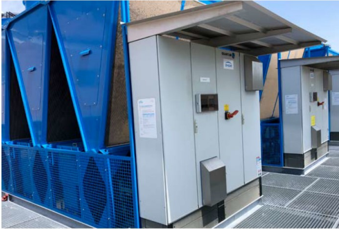
Kältemaschine auf dem Dach in Detailsicht
