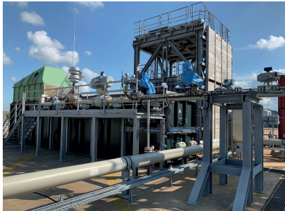
Bild 3. Überarbeitete Anlage zur Gas-Erstbefüllung. Bild: Rösberg Engineering GmbH
